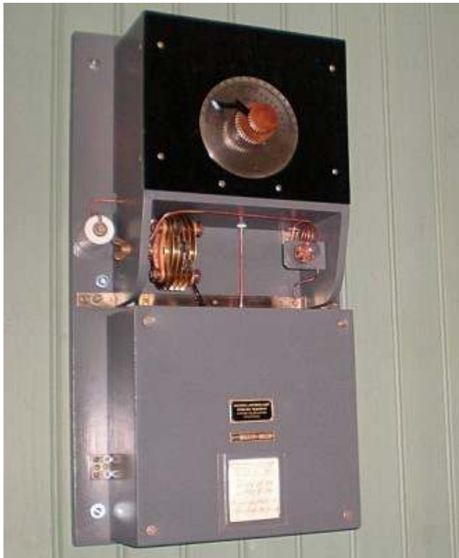
Bild 29. Den färdigrenoverade sändaren RTP 0,3 uppskruvad på väggen å Radiotelegrafstationen Gamlemark Radio. Kraftmatningen 35-60 VAC 500 Hz från lämplig motoromformare väntar på att anslutas liksom en LM Ericsson morsetangent och nämnda konstantenn.
