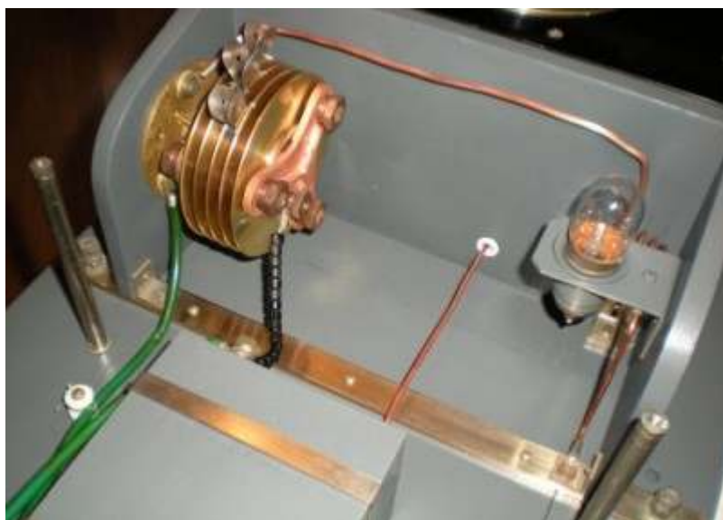
Bild 24. Gniststräckan passade perfekt i den vingmutterförsedda hållaren. Högspänningskablarna är isolerade med plastslang som trots sin höga ålder fortfarande var mjuka och smidiga.
