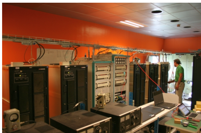
Vy över sändarna under igångkörning.
