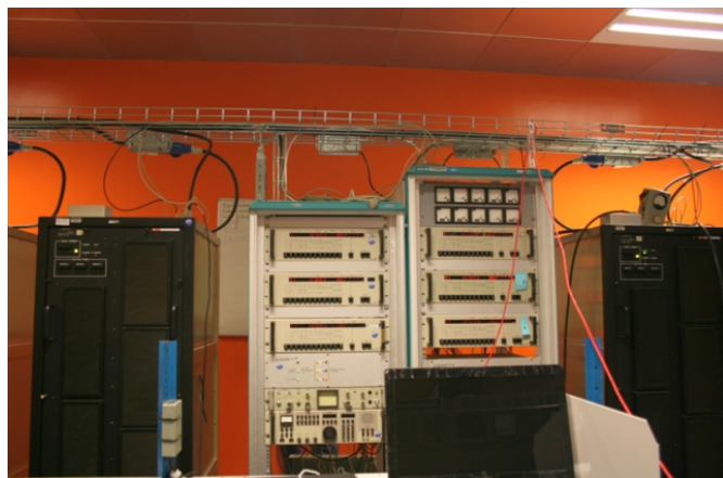
Styrstativet med SRT TD90 styrsändare och fjärrmanövrerad kontrollmottagare
