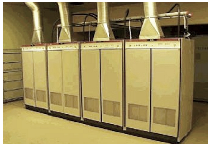
10 kW Collins effektsteg efter installationen 1988
