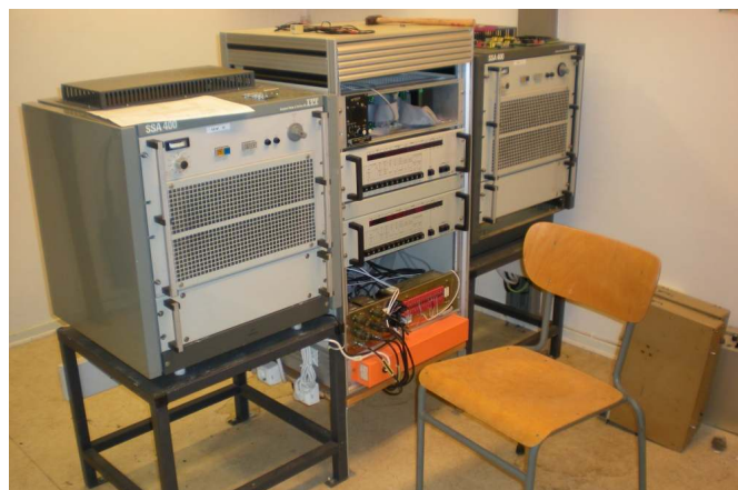
Gislövshammar MF, LV Basstation. Fjärrmanövrerad från Stockholm Radio, 2009. (Foto Bengt Falkenberg)
