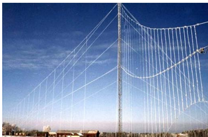
Bild 8. TCI vertikalpolariserat log-periodiskt antennsystem vid Enköping Radio
